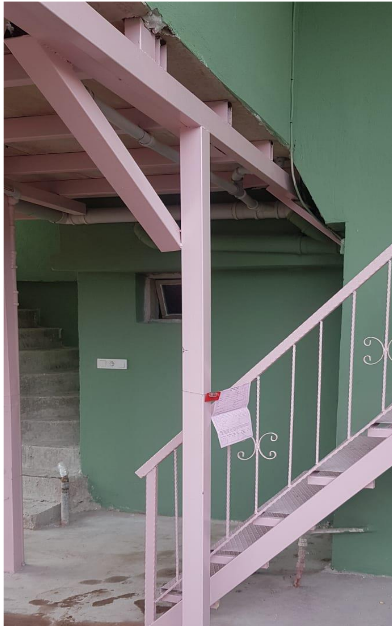
Kaçak Yapıların Mühürlenme Görüntüsü
